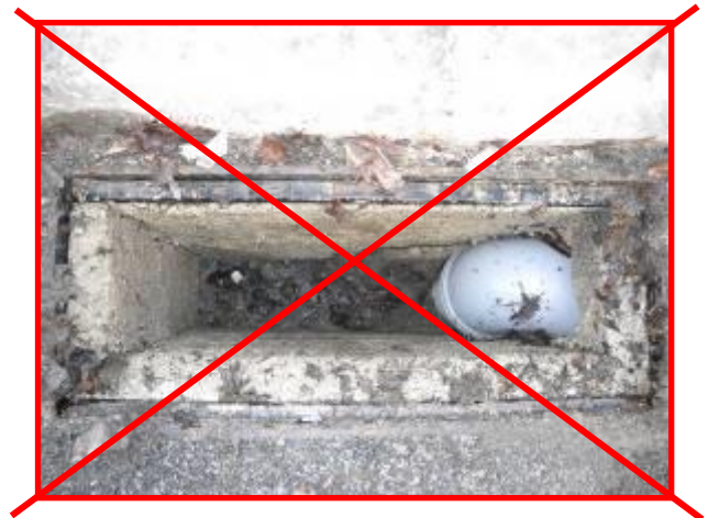
Avaloir de 700 x 200 mm intérieur : Dimensions insuffisantes, entretien impossible
