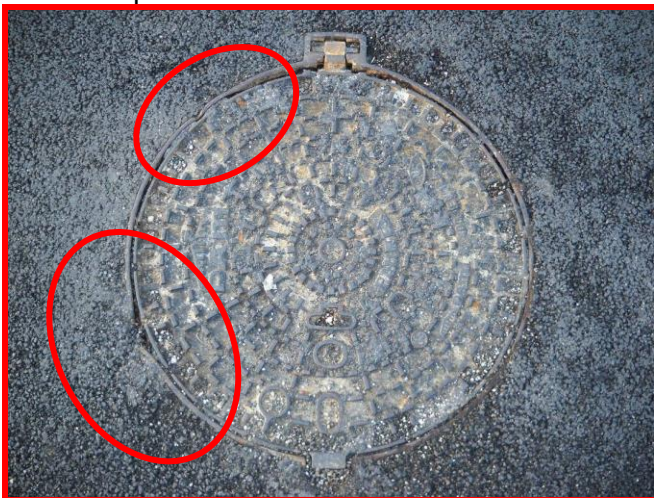
Tampon détérioré : à remplacer avant réfections définitives
