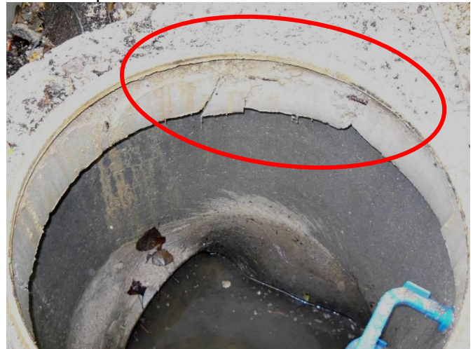
Dalle de réduction cassée suite au trafic de chantier : à remplacer avant réfections définitives.
