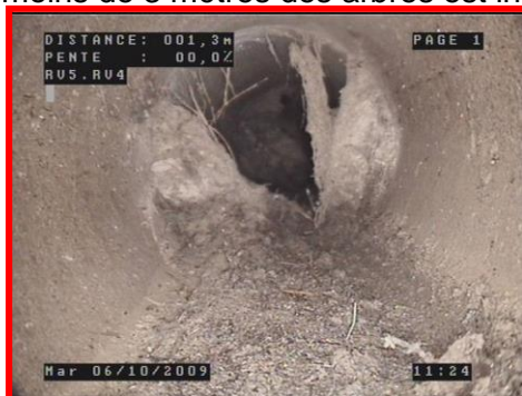
Obstruction partielle d'un Collecteur par des racines
