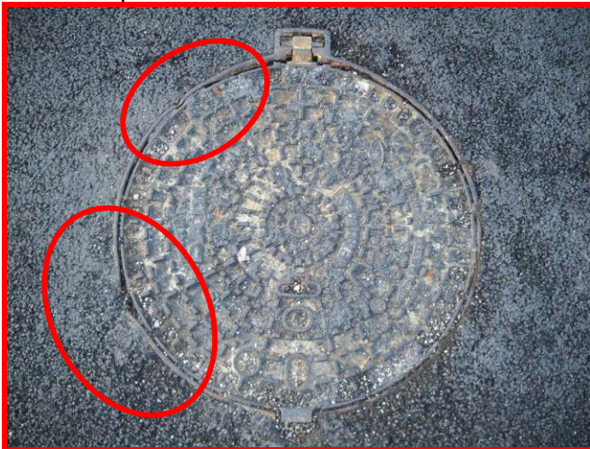
Tampon détérioré : à remplacer avant réfections définitives
