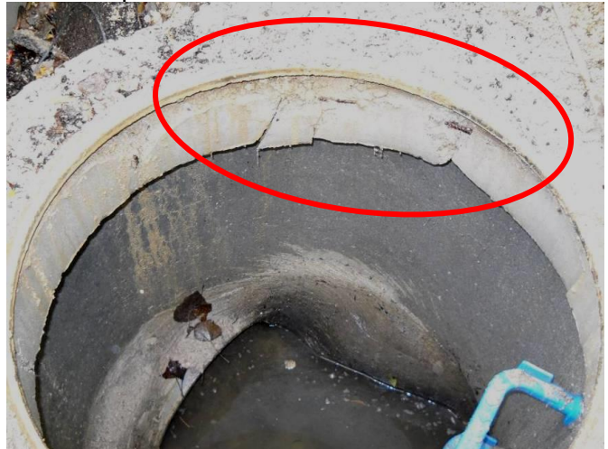
Dalle de réduction cassée suite au trafic de chantier : à remplacer avant réfections définitives.
