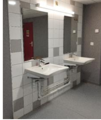
Douches transfert droit et gauche & lavabos
