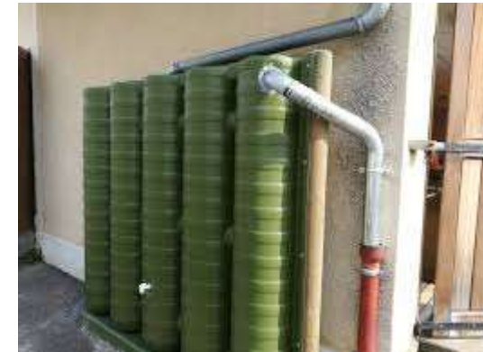
Cuves de récupération d'eau de pluie
